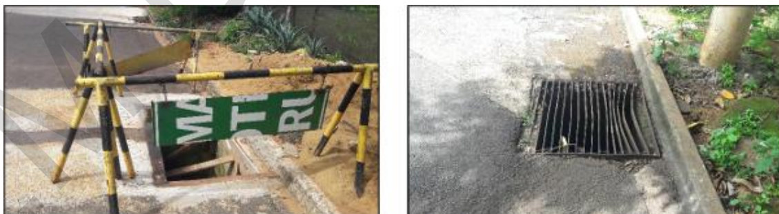
Figura 3.5.4.2-3: Registros dos dispositivos de captação no sistema de microdrenagem
